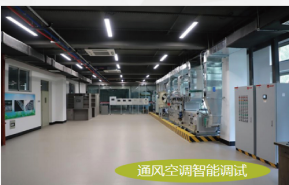
通风空调智能调试
